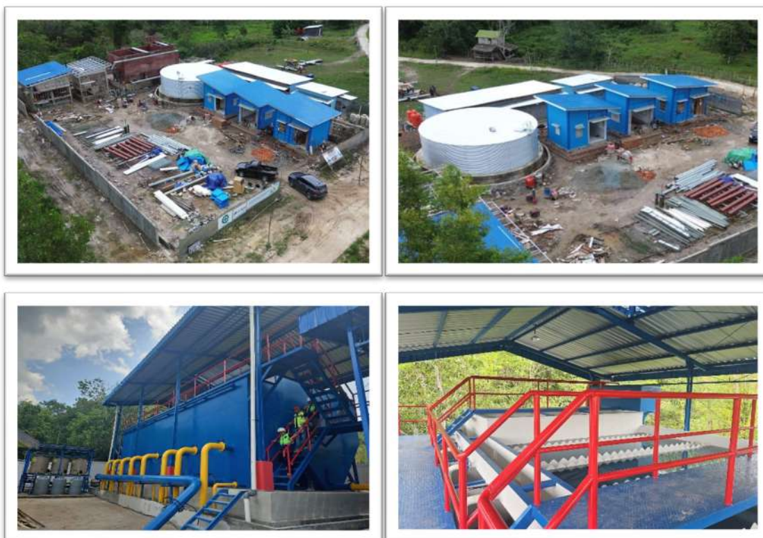
Pembangunan WTP 50 Ltr/Dtk SPM Sei Merdeka beserta prasarananya
